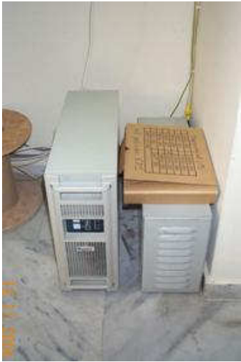
UPS για rack B
