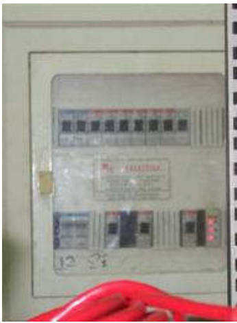
Ο ηλεκτρολογικός πίνακας
