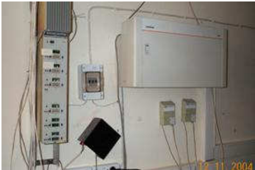
Τηλ. Κέντρο Alcatel & ISDN
