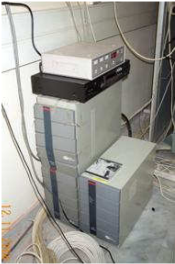
UPS για Rack A & Τηλ.Κέντρο
